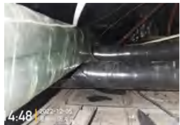
圣爵菲斯大酒店将原空调管道的保温材料更改为环保塑料材料，减少了热损失。
