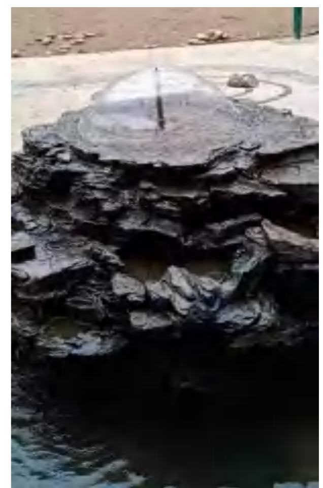
长沙世界之窗对原鹿园竹林废弃深水井重新利用，从中采集地下水供给动物饮水及景观喷泉水，每日可提取地下水约30余吨，每月节约水费约3700元。
